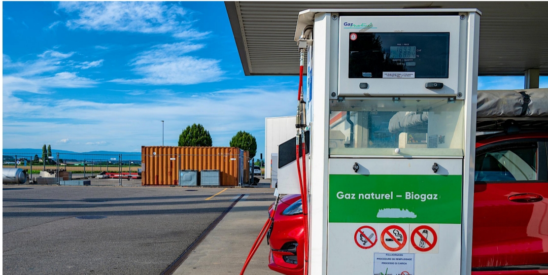
La pompe à gaz sur la route de Bussy ne sera plus en service à la fin de l'année.
